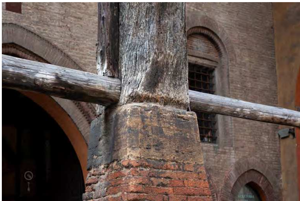
Fig. 10. Particolare piedistallo in muratura del portico di Palazzo Isolani, Ph. Nicola La Terra.
